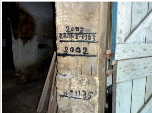
1993 repère peint - 2002 repère peint 2003 repère peint - 1935 repère peint
