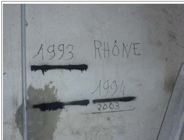
Repère n°3 : chemin de la Calmette, sur le mur d'un garage
